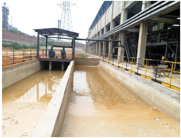
水渣渗滤液收集沉淀池
